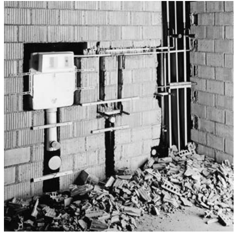
Abbildung 9: Mauerwerkssanierung ist hier nötig. An die Kosten und den Schallschutz dachte niemand.
